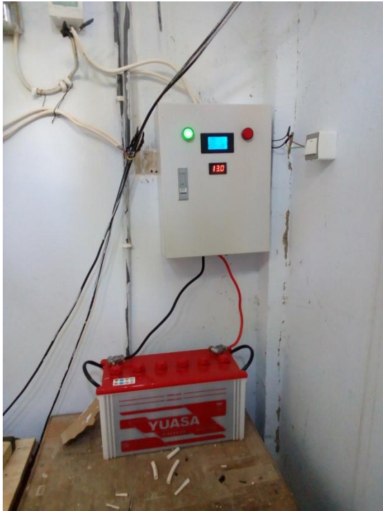
Gambar 6. Inverter yang telah terpasang
