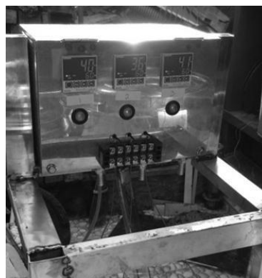
GAMBAR 3. Kotak sistem kontrol
