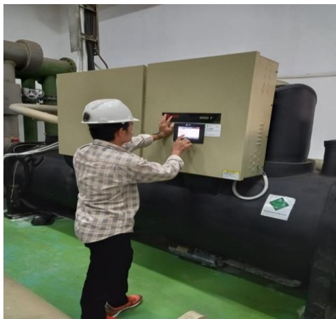
Gambar 1. Observasi pada mesin chiller
