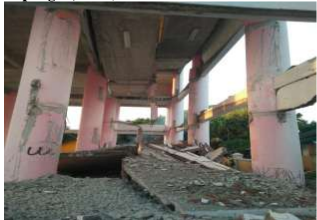
Gambar 11. Kerusakan struktural yang terlihat pada elemen kolom lantai pada bangunan TES Bangsal. (Sumber:Survey Lapangan, 2018)
