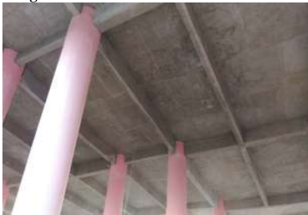
Gambar 13. Kerusakan struktural yang terlihat pada elemen plat pada bangunan TES Bangsal.
