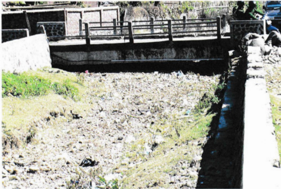
Gambar 2.1. Deposisi sedimen di hulu jembatan sungai Jama' (Saadi, 2008b)
