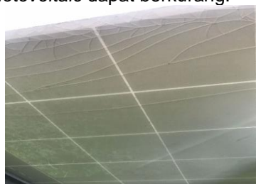
Gambar 4. 17 Modul Fotovoltaik Retak Pada Array Box E01.D01.A02.S03
