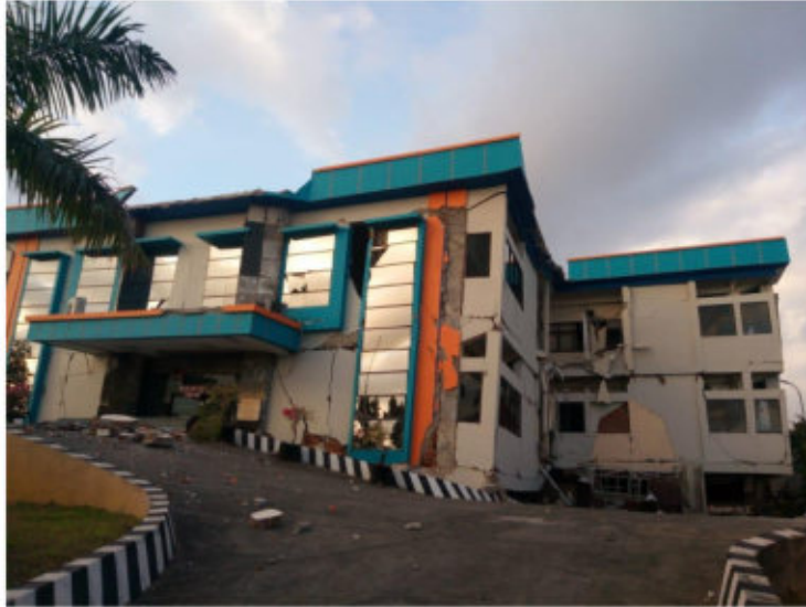
Gambar 4 Kerusakan Berat Bangunan Besar di Kota Mataram
