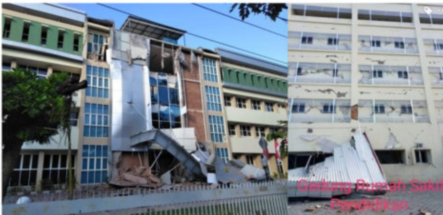
Gambar 5 Kerusakan Bangunan Universitas Mataram
