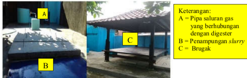
Gambar 4. Instalasi biogas dengan kapasitas 4 m 3 .
