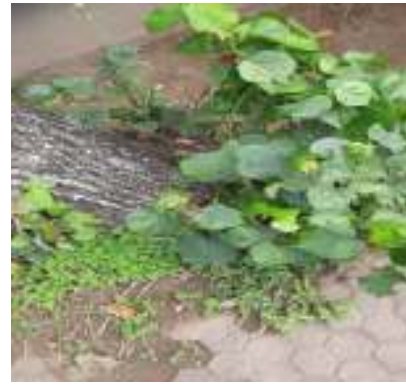
Gambar 8. Kerusakan brum akar di jalur hijau
