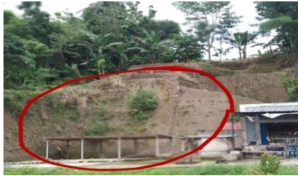
Gambar 1 Keadaan lokasi tempat pernah terjadinya longsor
