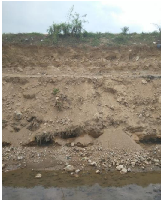
Gambar 4.2 Bentuk Asli Lereng pada Ruas Jalan Patung Sapi Gerung – Mataram
